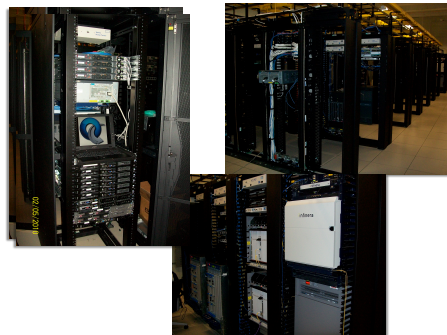
IU Bloomington Data Center Testlab
